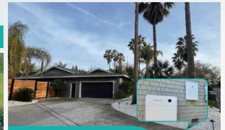
Verenigde Staten 11,4 kW AC-uitgang 13 kWh ESS-capaciteit
